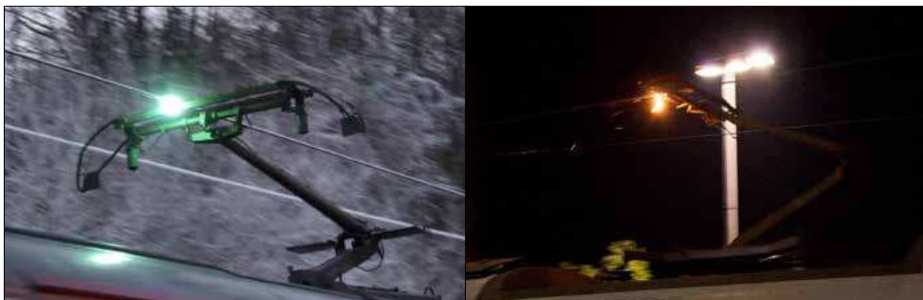
Figura 1. Arco elettrico conseguenza del distacco catenaria-pantografo
