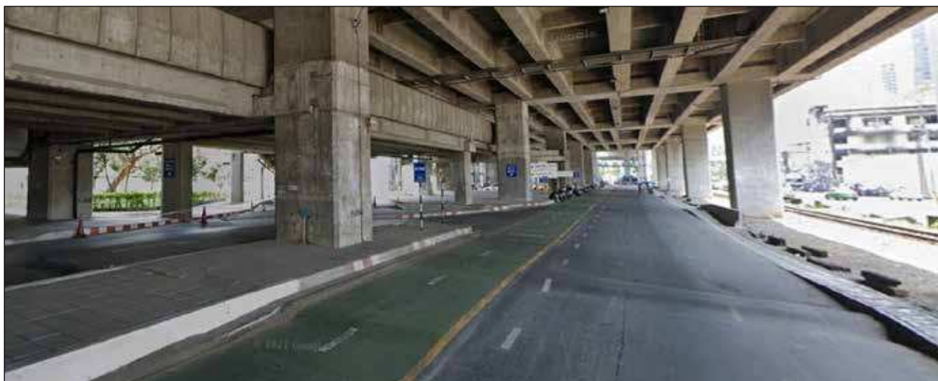
Figura 1 - conseguenza della subsidenza presso la stazione di Makkasan
